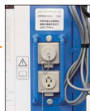
》100V電源取出口
